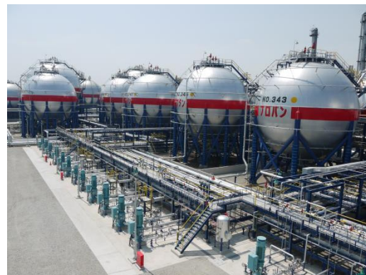
千葉製油所 新設されたLPGタンク群
