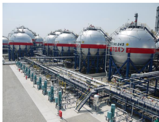
千葉製油所 新設されたLPGタンク群
