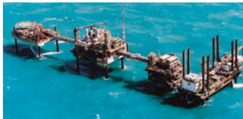
カタールプロジェクトの生産設備
