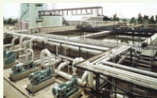
排水処理装置で余剰汚泥を80%削減予定
