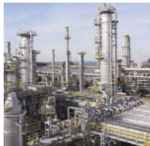
パラキシレン製造装置
