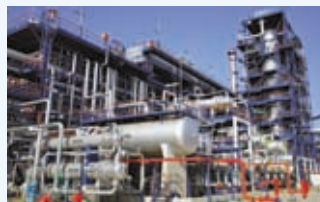
硫黄分などを除去する分解油水添脱硫装置
