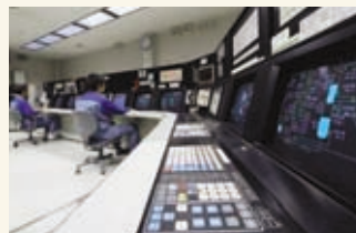
設備の安全稼働を監視する運転管理室
