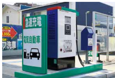
EV車向け急速充電器
