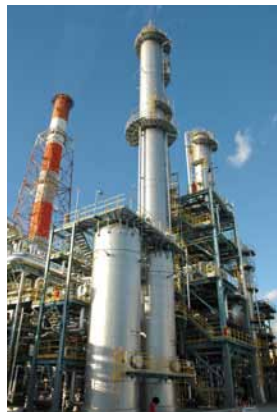
四日市製油所に新設したミックス キシレン製造装置
