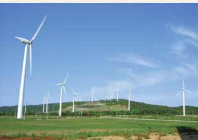
エコ・パワー社、青森県の風力発電設備 「岩屋ウィンドパーク」
