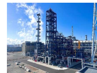
(SAF製造設備)
