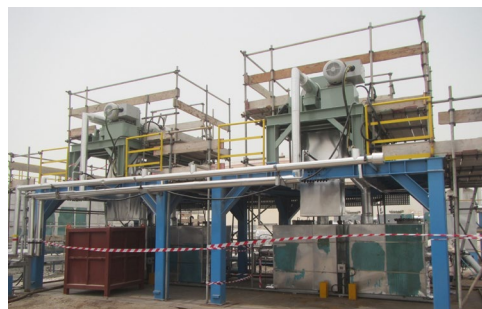
遠心分離設備
