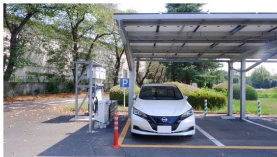
中央研究所に設置したソーラーカーポート、蓄電池、EV 車両と充電設備
