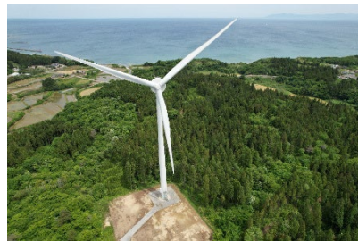
風の杜おが風力発電所
