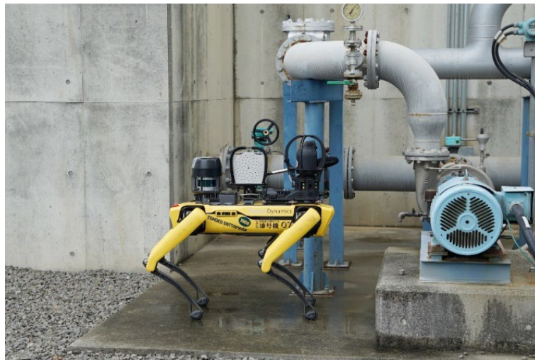
堺製油所で試験的に実施した四足歩行ロボットによる設備データ取得の様子
