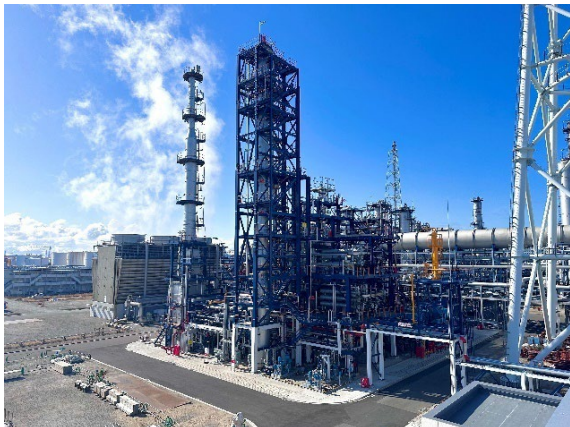
完工した SAF 製造装置
