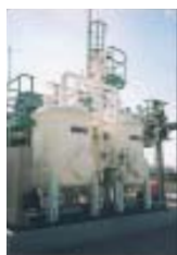
炭化水素ベーパー回収装置
