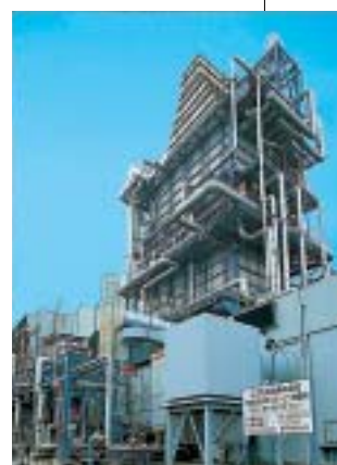
千葉製油所の コージェネレーション設備
