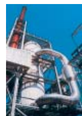
ダイオキシン除去装置
