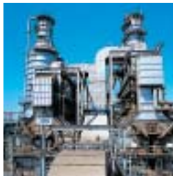
排煙中のNOxを除去する排煙脱硝装置
