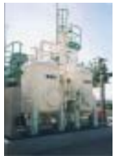
炭化水素ベーパー回収装置
