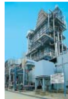
千葉製油所の コージェネレーション設備
