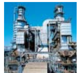
排煙中のNO x を除去する 排煙脱硝装置
