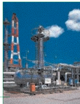
炭化水素ベーパー回収装置
