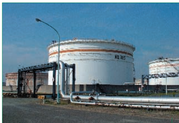
浮屋根式タンク（フローティングルーフタンク）
