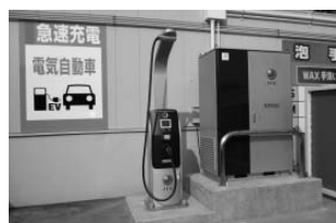
電気自動車用 急速 充電器
