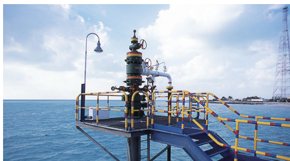
地下へ排水圧入を行う圧入井
