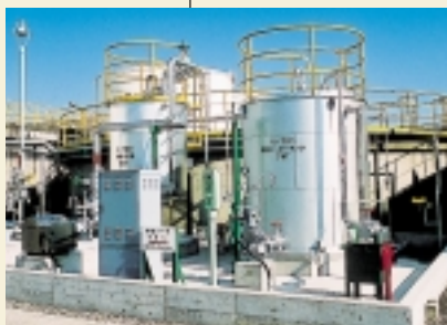
坂出製油所の汚泥減容化システムの実証プラント
